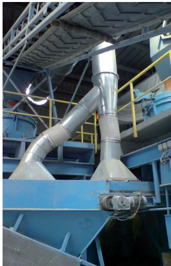
Afb. 5 Aan elkaar geschakelde installaties op één enkel afzuigpunt
