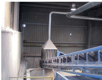
Afb. 3 Een overstortpunt met één afzuigkap
